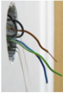
Fils électriques exposés.
